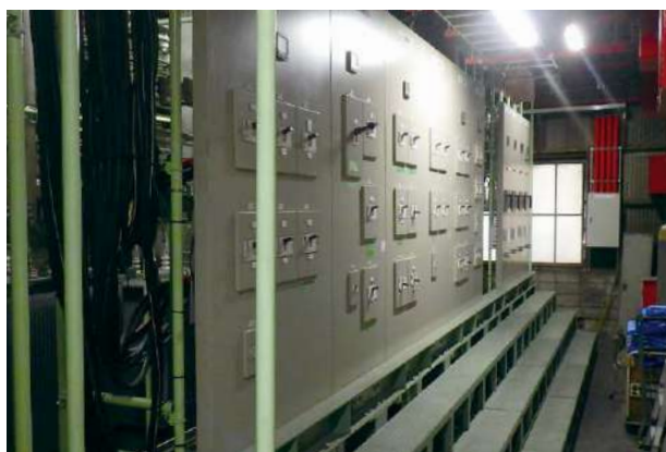
東大阪工場における冠水対策としての配電盤嵩上げ実施例
