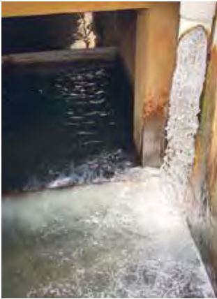
枚方工場 浄水処理施設
