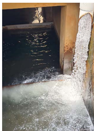
枚方工場 浄水処理施設
