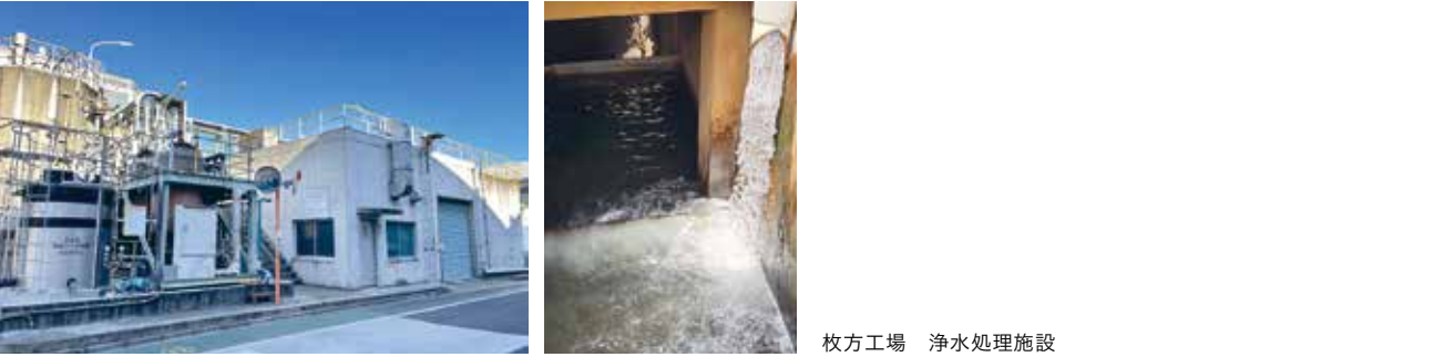
枚方工場 浄水処理施設
