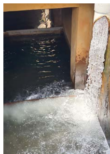
枚方工場 浄水処理施設
